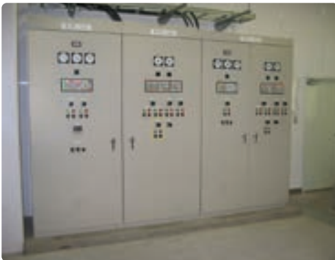
ポンプ制御盤
