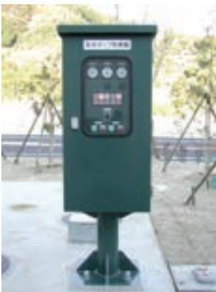
トリミズ 取水ポンプ制御盤
