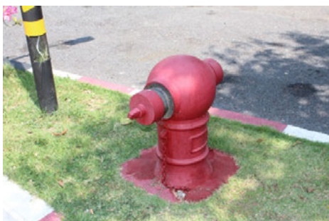
バンコクの立管式消火栓
