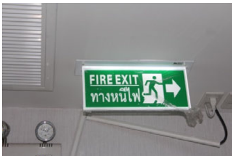
避難口誘導灯
